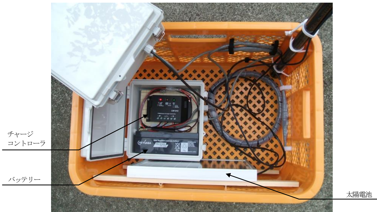
写真15 太陽電池とプラボックス内のチャージコントローラ、バッテリー
